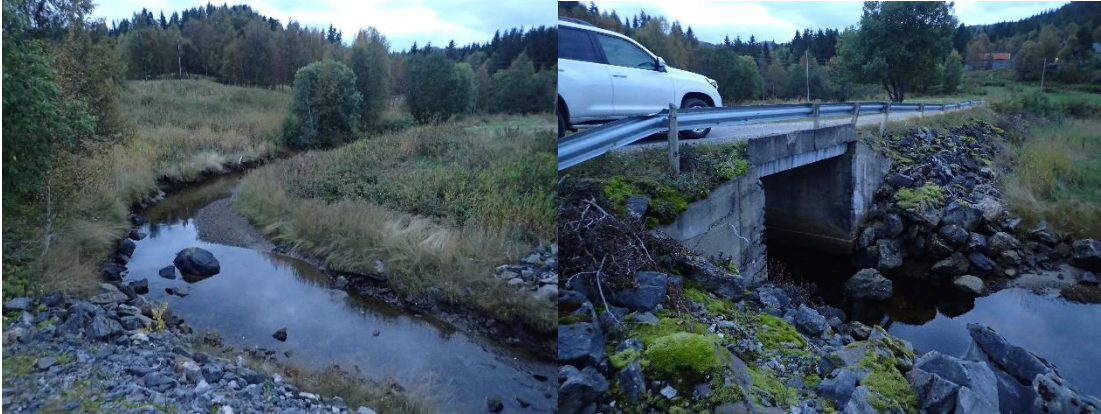
Bilde: Nedre deler av Røytvollelva (t.v.) og betongbru ved utløp i sjø (t.h.).
