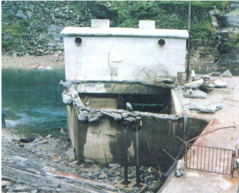
Figur 1-2 Skader på bekkeinntaket i Eide – Fannadalen etter kraftig utblåsing (Hoel, 2009).
