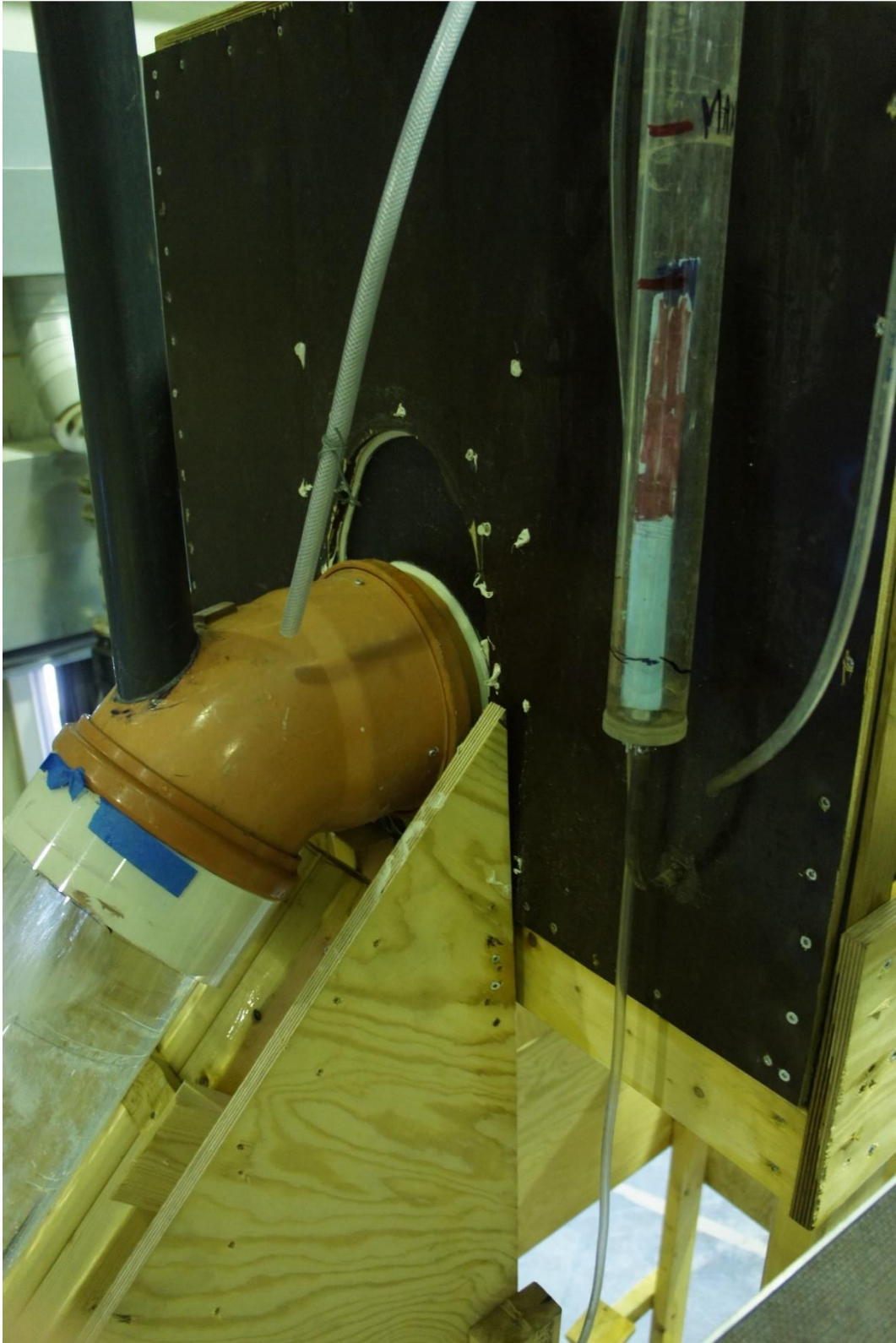
Overgang inntakskasse/sjakt, lufterør og vasstandsmåler
