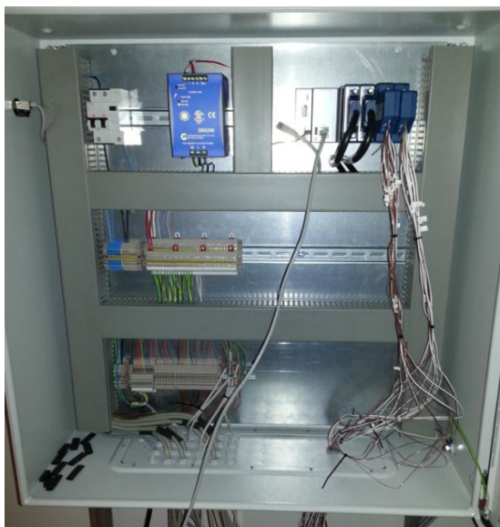
Figur 19 Bilde av skap for mottak av signaler fra følere i rom
