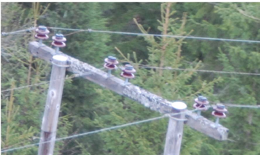
Figur 29, Observasjon 7, Mast - tre - råteangrep
