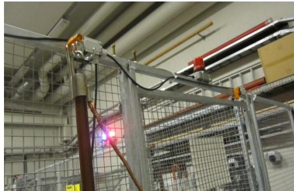
Figur 3-2, Bilde av brytere og farelampe.
