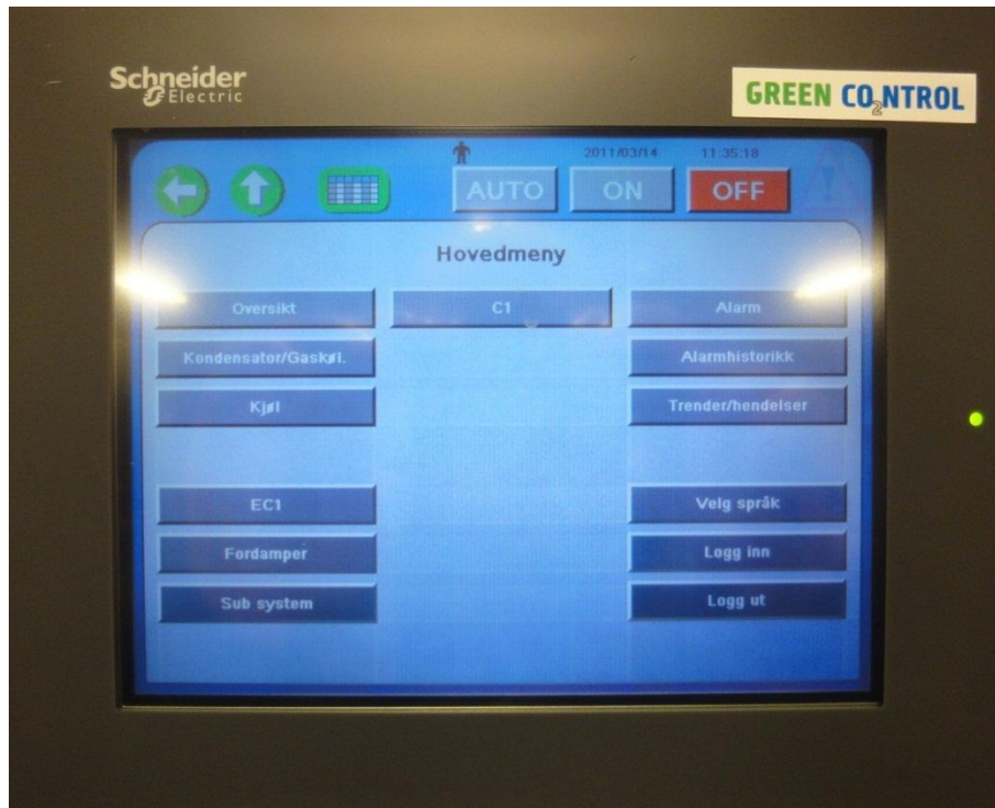
Figur 3-8 Kontrollpanelet på Green & Cool kjøleanlegg
