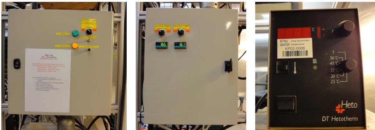
Figur A-9 Styring av rigg før oppgradering
