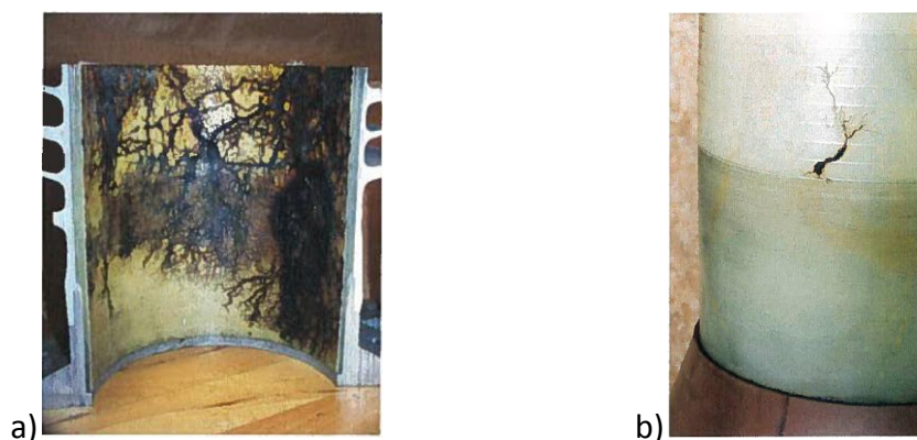
Figur 11 – a) Øvre del av kompositthus der overflaten er kraftig korrodert som følge av overflateutladninger (tracking) initiert av vann. b) overflateutladninger i fremkant av endeavslutning som har kraftig erodert PEX-isolasjon. [17]
