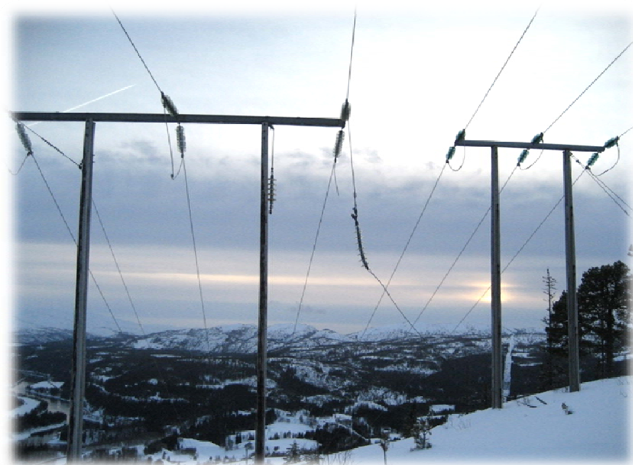
Bilde 1.1. Anleggsarbeidere til NTE fotograferte faseavbruddet på overføringslinjen fra NFK mot Namsos S som førte til de ukontrollerte effektpendlingene i R-nettet den 7. mars 2008.
