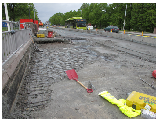
Figur 3.9: Vestre enden av brua etter fjerning av delaminert betong [3]
