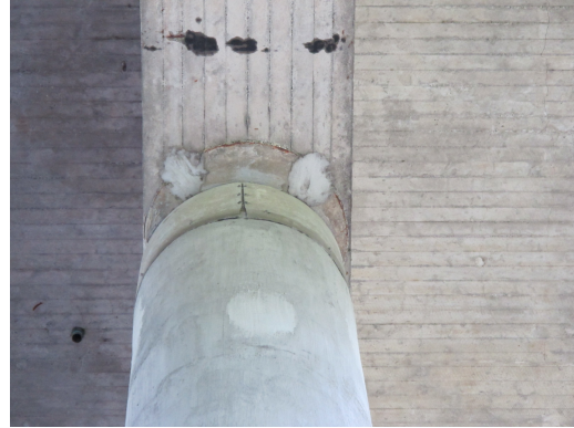
Figur 3.14: Søyle i akse 9 etter flytting av lageret i bjelken [4]
