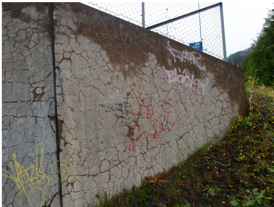
Figur 2.4: Krakeleringsriss fra alkalireaksjoner [eget bilde]
