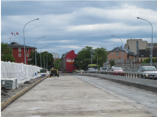
Figur 3.10: Østlig side av brua etter fjerning av asfalt og membraner under rehabiliteringen av brua i 2014-2015 [3]
