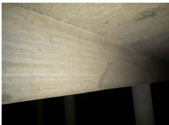
Figur 3.16: Riss i momentnullpunkt [16]
