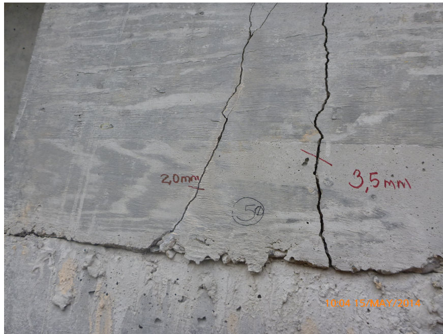
Figur 4.6: Sprekk i tverrbærer akse 5 mot øst.
