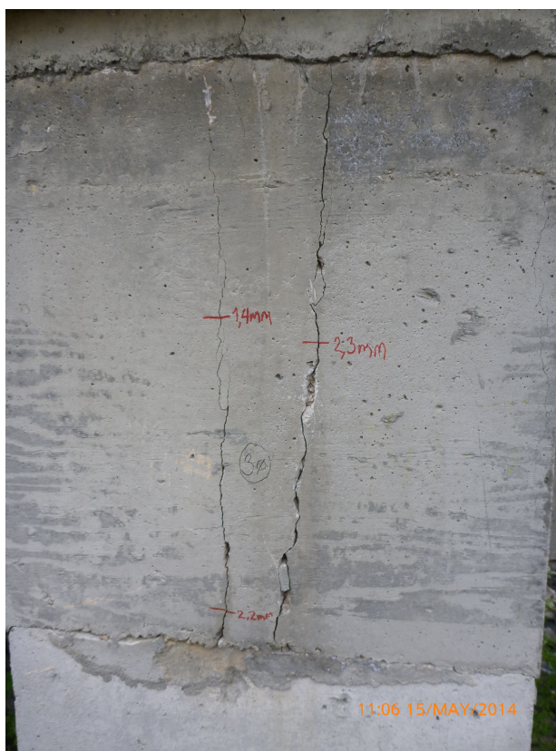
Figur 11.1: Vertikalriss på tverrbærer i akse 3 mot øst.
