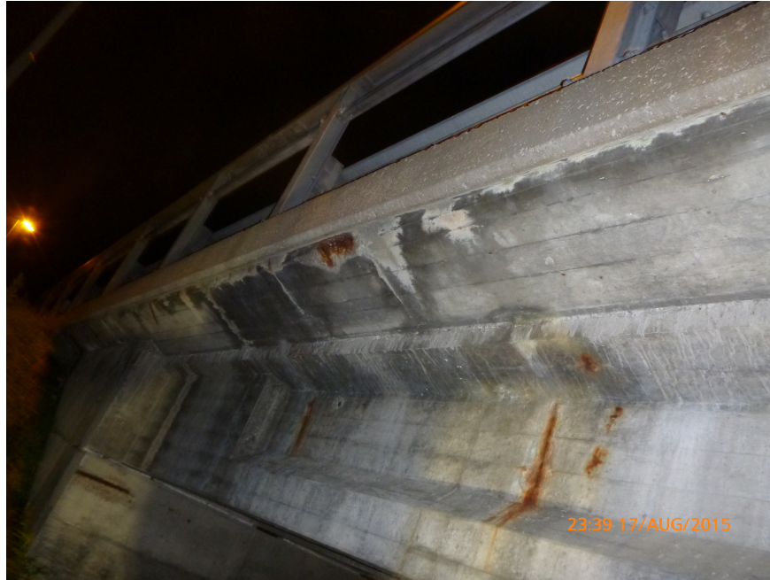
Figur 4.5: Armeringskorrosjon på NIB-bjelker.
