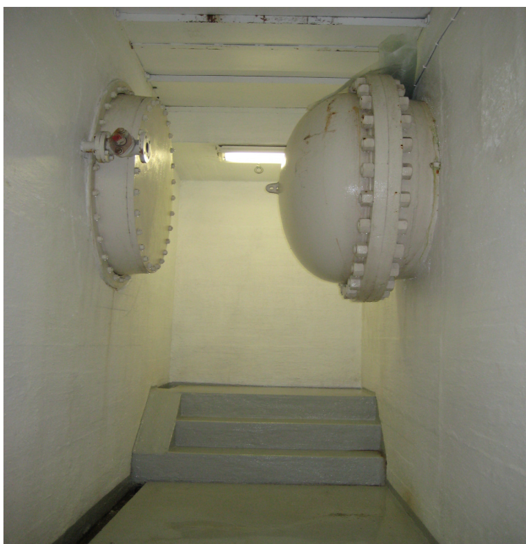
Bilde 2-1 Bukserøret i maskinsalen på Fosse kraftverk
