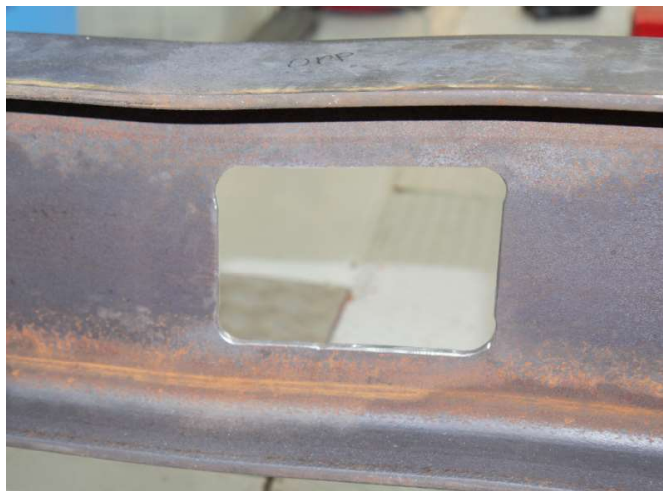
Figur 4.6: Permanent deformasjon over åpning.
