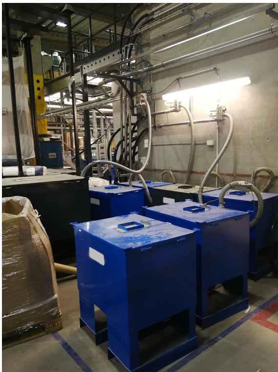
(a) Masterbatch som ikke brukes mye lagres i små containere og kobles til rørsystem ved bruk.
