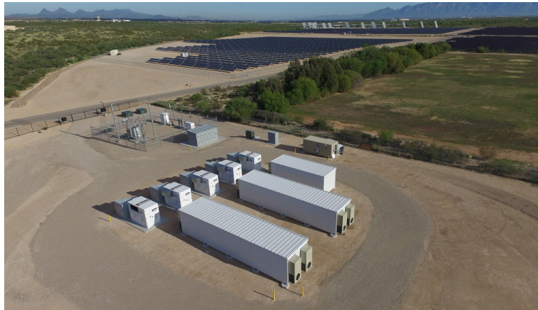
Figur 62: Batteripakke (Toshiba SCiB) i Arizona på 10 MW [47]
