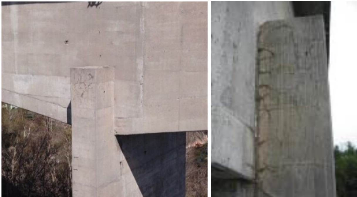
Figur 5.15: Krakeleringsmønster observert på Søyle D
