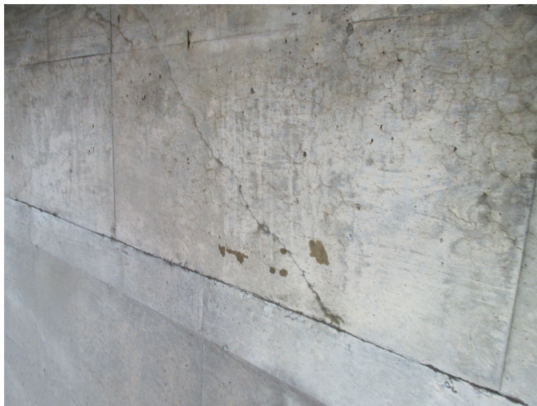
Figur 5.14: Riss i øvre 1,5 m av kassesteg
