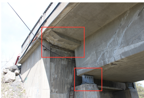
(a) Fuktskader ved landkar A
