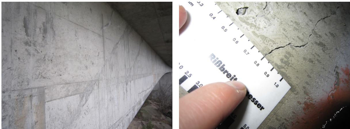
Figur 5.7: Skjærriss og rissvidde fra D mot C (Aas-Jakobsen, 2014)
