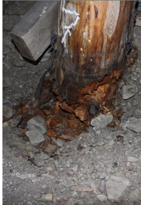
Figur 14: Nærbilde av råteskadet trepel (Bildet er ikke fra Spisshus) (Foto: M. Haugan)
