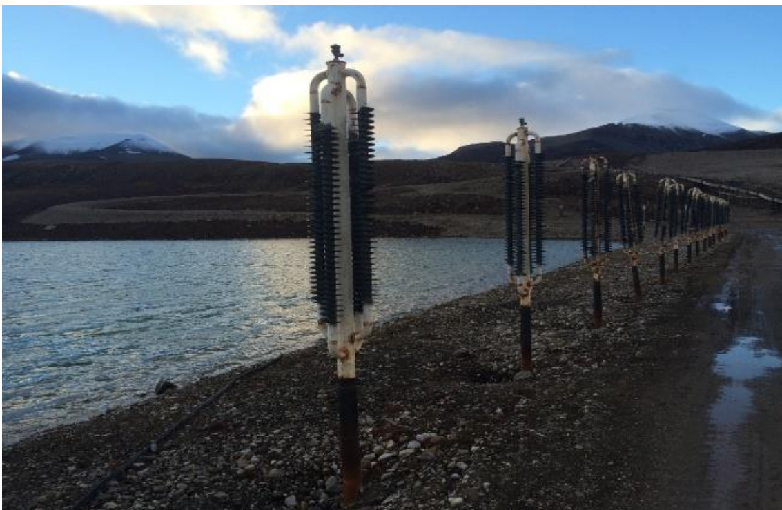
Figur 5: Thermosyphon ved vannmagasin ved Pyramiden på Svalbard (foto: M. Haugan)
