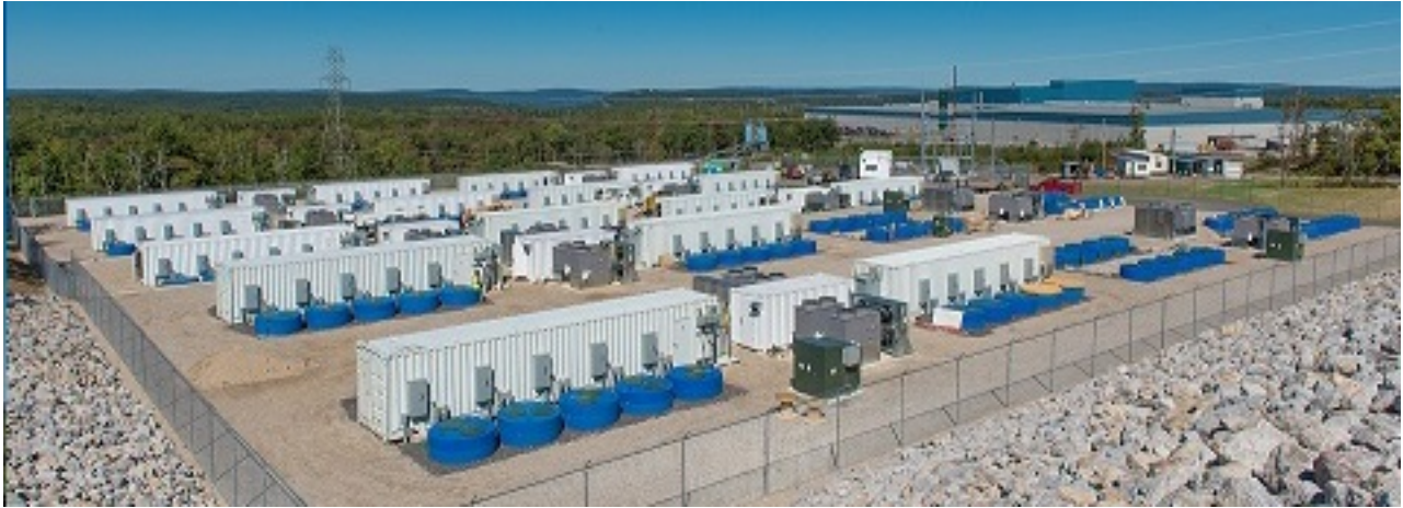
Figur 2.14: Et Equinor-støttet 20 MW svinghullager i Pennsylvania, Convergent Energy + Power[11]
