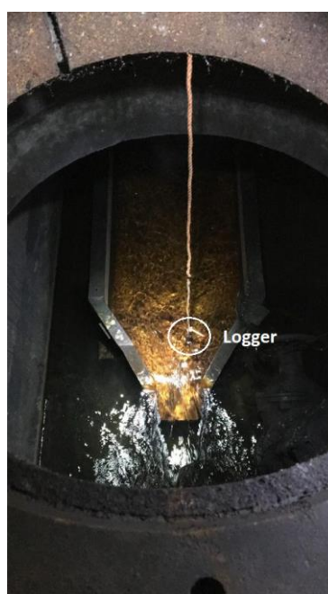
Figur 5.4: Plassering av logger i drenskum ved pr. 7210 (privat foto).
