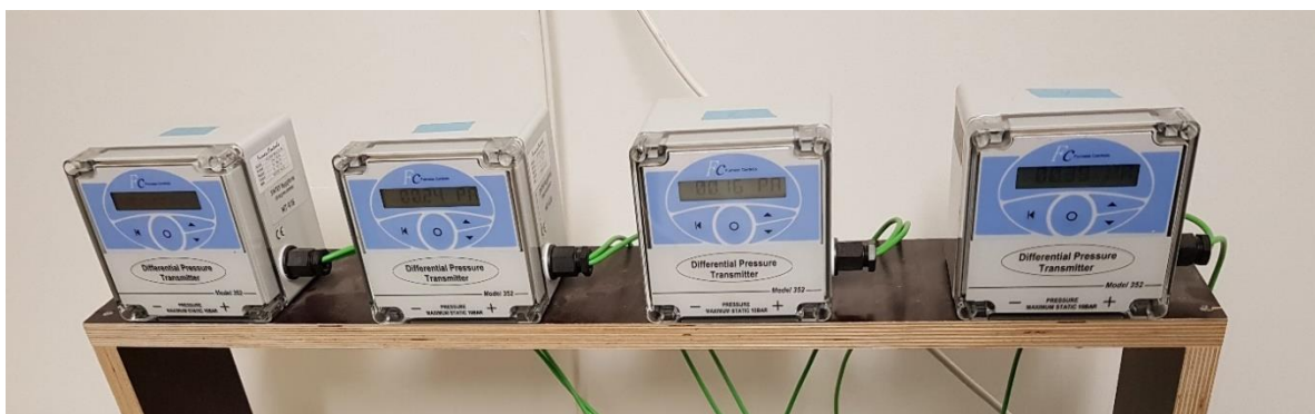
Figur 3.17 Mikromanometer montert på ramme
