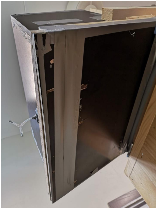
Figur 2 Lukket spalteåpning i raftekassen
