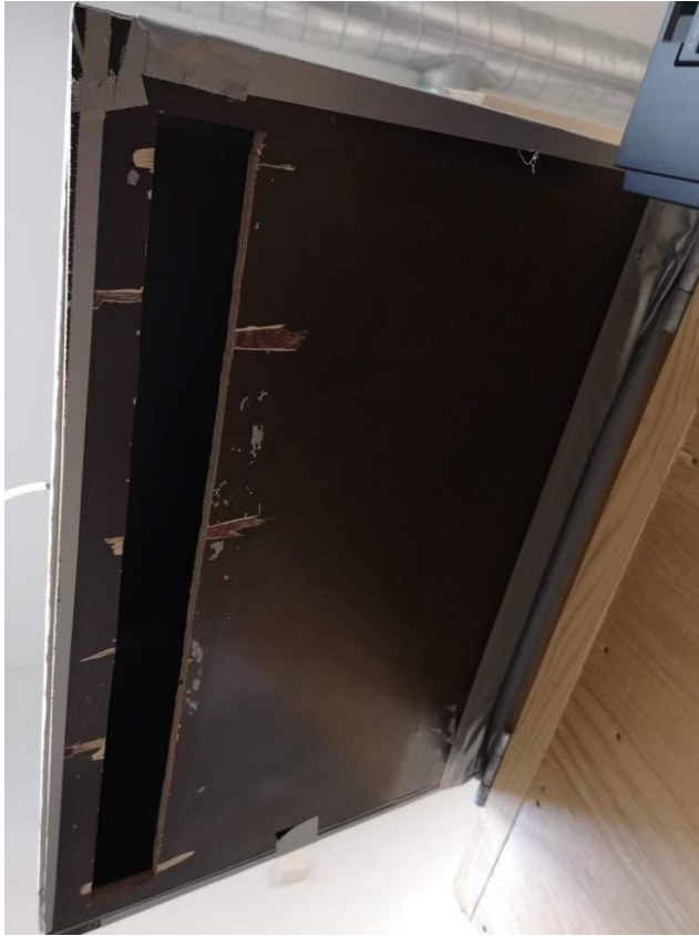
Figur 1 Åpen spalteåpning i raftekassen
