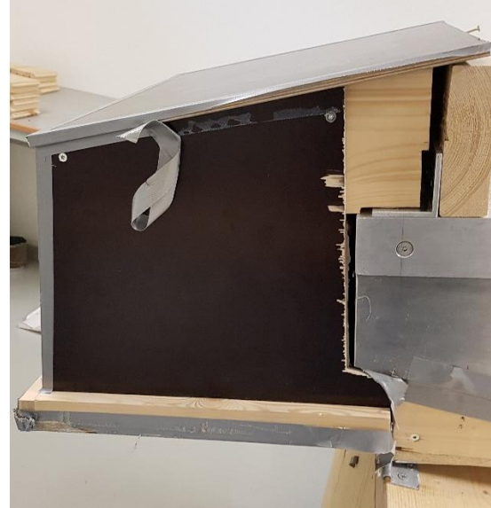
Figur 3.10 Raftekassen sett fra siden
