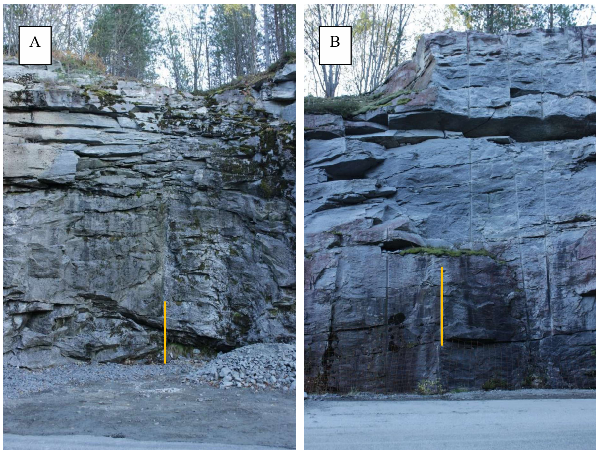
Figur 3.17 - Lokalitet 6: Oppsprekningen i forskjæringen ved portal sør. Oppsprekningen er overflateparallel. Bergmassen fremstår generelt mer kompakt mot dyp. Bilde (A) er tatt mot øst, og viser hyppigere oppsprekking de øverste 5 meterne mot overflaten. Bilde (B) er tatt mot vest. Gul målestokk er 2 meter lang.
