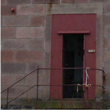
Ytterdør, vegg mot NØ. God stand, behøver vanlig vedlikehold.
