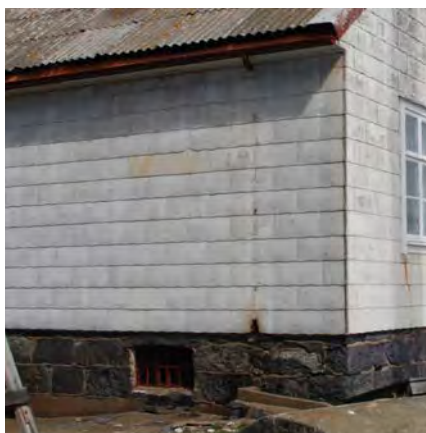
Nedløpsrør mangler, vegg mot SV.
