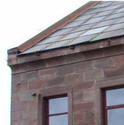
Takrenner og nedløp: Manglende takrenne og nedløp, vegg mot NØ.
