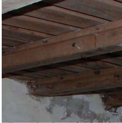
Dekker, primærkonstruksjon. Sett fra kjeller. God stand, med unntak av der det er skåret ut lufteslisse i dekkene.
