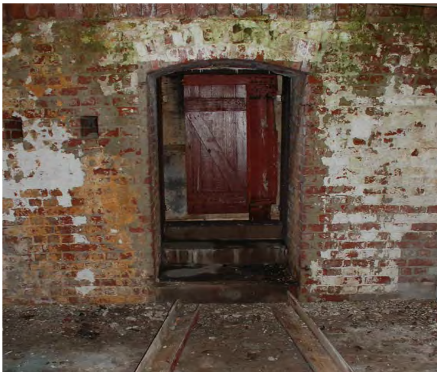
Yttervegg med algevekst og avflasset puss mot sørvest, i kjelleren til fyrbygningen. (F-0-03)
