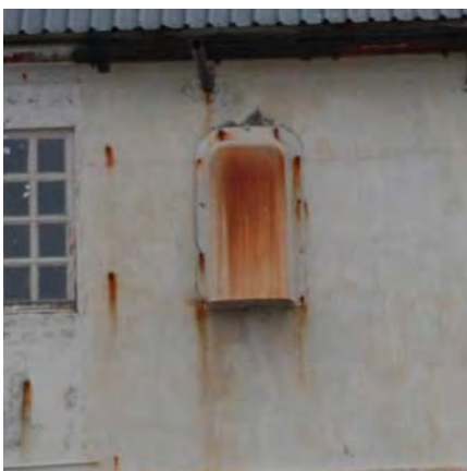
Ventilasjon: Utvendige rustskader i fasade.
