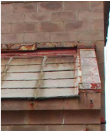
Taktekking: Skiferplater. Mangler beslag enkelte steder. Tårn mot NØ.
