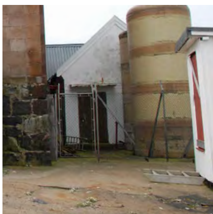
Øvre utedo: mot Maskinhuset. Døra er igjenspiKET. Løs trapp.
