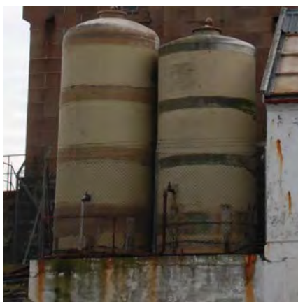
Dieseltanker, NØ for maskinhuset.
