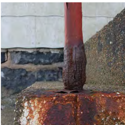
Trapp: rustskadet gelender, trapp mot NØ.
