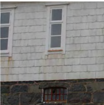
Vinduer: Støpejernsvindu med knust rute og torams vindu ned rust på vanbrett, fasade mot SØ.
