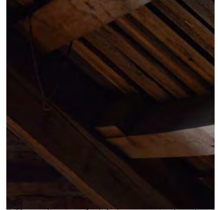
Takkonstruksjon: sett fra loft. Sperre- og åstak, undertak av under- og påbord.
