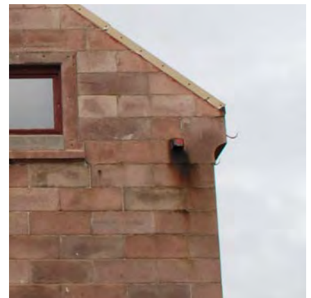
Ventilasjon: Utvendige rustskader i fasade.
