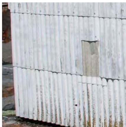
Naust: Fjernet vindu, mot SV.
