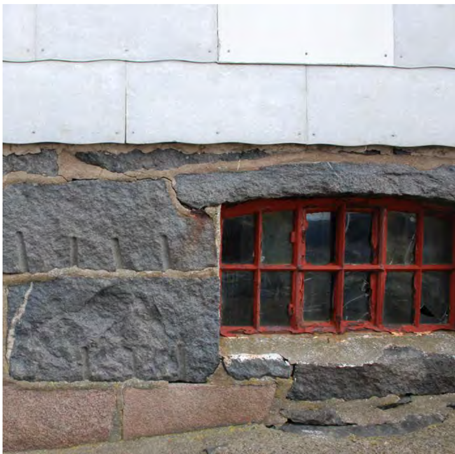
Assistentboligen. Rød granitt nederst i grunnmuren (antakeligvis overskuddsstein fra fyrbygningen) og naturstein. Rødmalt støpejernsvindu til kjelleren.
