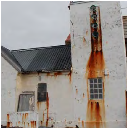
Yttervegger: store rustskader. Vegg mot SV.
