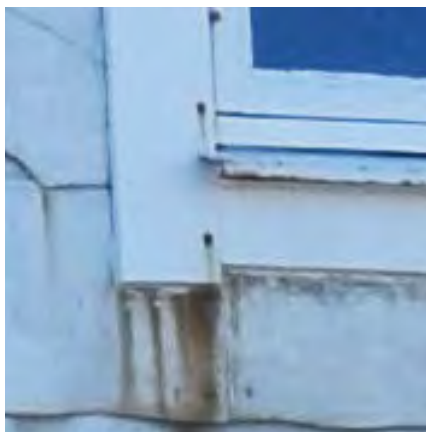
Utvendig kledning. Rustskade på eternitt mot NØ.
