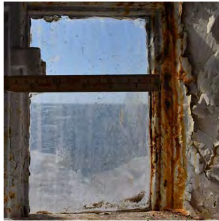
Støpejernsvindu mot SV. Rust og avflasket maling innvendig.
