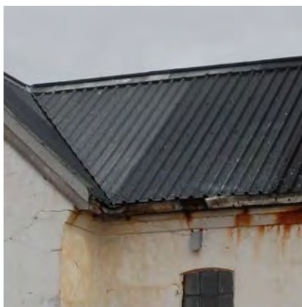
Takrenne og nedløp: mangler. Vegg mot SV.
