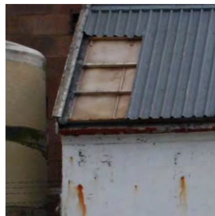
Taktekking: Plate mangler.
