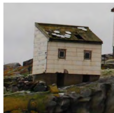
Nedre utedo: Tekkingen har blåst av. Stort hull i taket.
