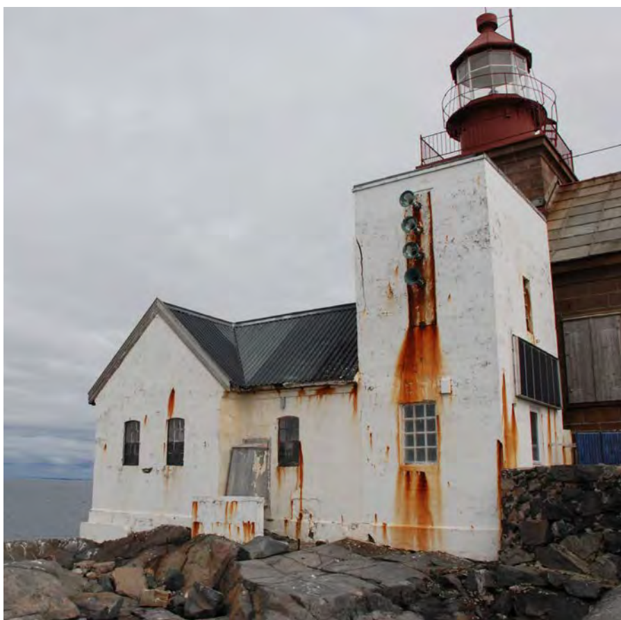
Maskinhuset sett fra sørvest. Fasaden har store rustskader, særlig under takelurene.
