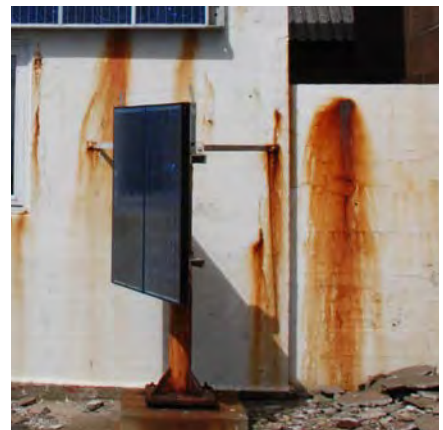
Yttervegg/mur mot fyrbygning: Rustskader.
