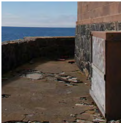
Drenering: oppsprukket dekke langs vegg mot SV.
