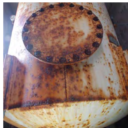
Trykketank til tyfon: utvendige rustskader.
