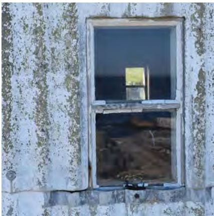
Naust: Vindu med manglende vannbrett mot NØ. Vindustramma må pusses og skrapes.
