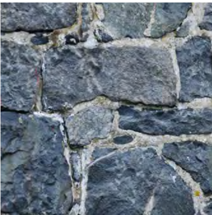
Fundament: enkelte sprekker i fugene. Vegg mot NØ.
