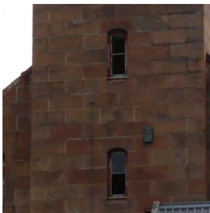
Vinduer 2): Knuste ruter på vegg mot NV. Rammene pussing og maling.
