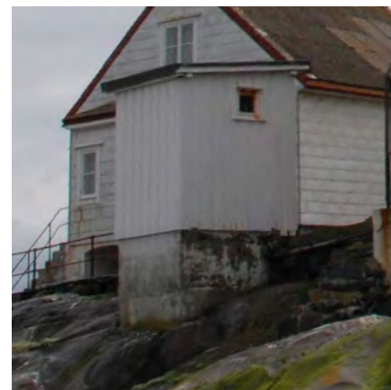
Øvre utedo: fasade mot SV. Noe rust rundt vindu.
