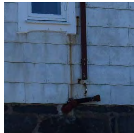
Takrenner og nedløp: Nedløp er frakoblet sistene.
