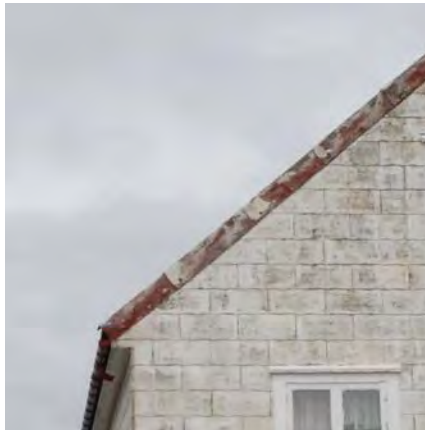
Takkant mot SØ. Vindski behøver vedlikehold.
