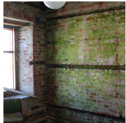
Veggkonstruksjon: Innmur av tegl. Innvendig foring fjernet. Algevekst. Vegg mot NØ
