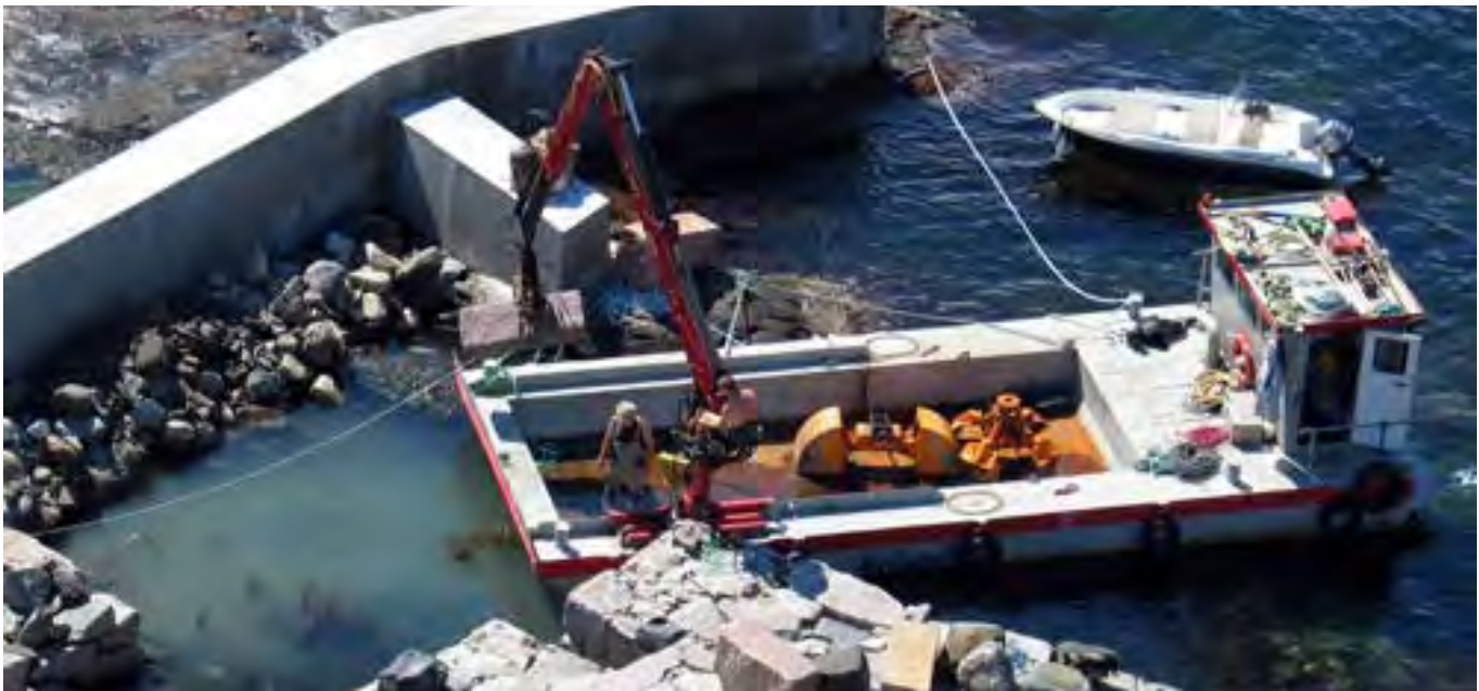
Denne siden: Eksempel på utbedrede landingsforhold i senere tid: Lille Torungen: Båtopptrekk med ny tørrmurt bølgebryter. kilde: torungen-fyr.no M
