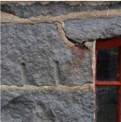
Fundament: Sprekker etter rustsprengning over kjellervinduene i støpejern.
