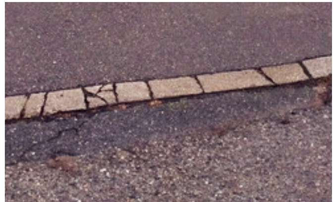
Figur 116: Nedsenket fortauskant opp mot kirka
