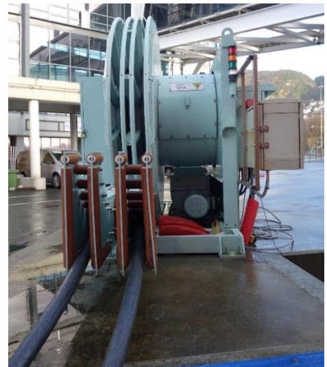
Figur 8: Kabeltrommel til landstrømstilkobling. Bilde tatt med tillatelse under besøk.
