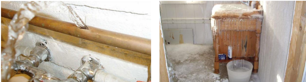
Figur 2.2: Frostsprengt rør som lekker vann og omfattende frostskafer på et bad (Pihl og Aamodt-Hansen, 2012) og (Grosvold, 2016)
