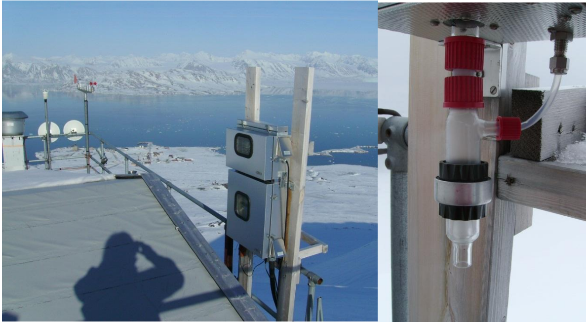
Figur 7: Fraksjoneringsenheten på taket av Zeppelinstasjonen, Ny-Ålesund og Kongsfjorden i bakgrunnen, samt luftinntak, her uten varmekappe til ære for fotografen (Foto: Moen, 2011).
