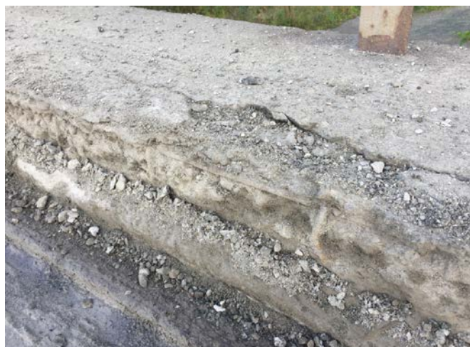
Figur 2 Støtteskader ved snøbrøyting kombinert med frøstskader på Fv.65 Forve bru [2017]
