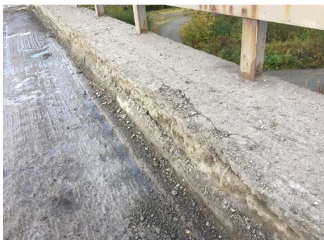
Figur 1 Støtteskader pga snønrøyting på Fv.65 Forve bru i 2017
