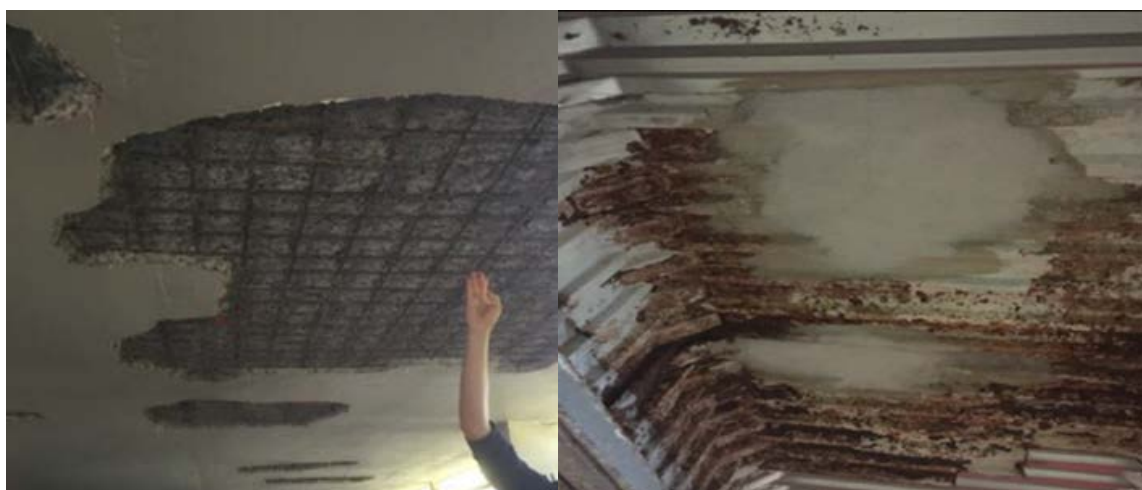
Figur 29 Klorider trukket ned gjennom hele konstruksjon [19]
