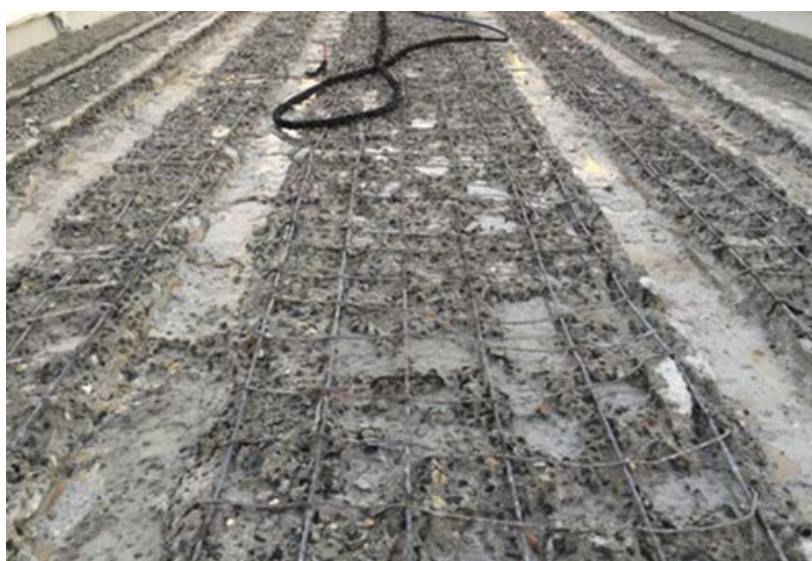
Figur 41 Ujevnt overflate etter vannmeisling på Ladedalen bru i 2015
