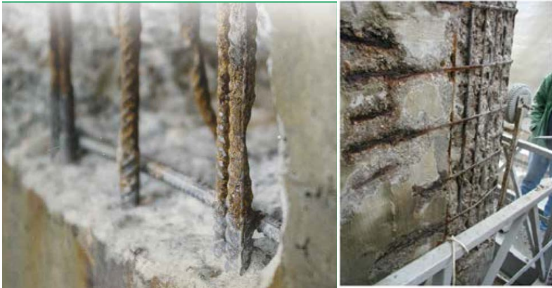
Figur 57 Redusert armerings tverrsnitt pga. armeringskorrosjon [36] Korrodert armering og veldig lite overdekning [34]
