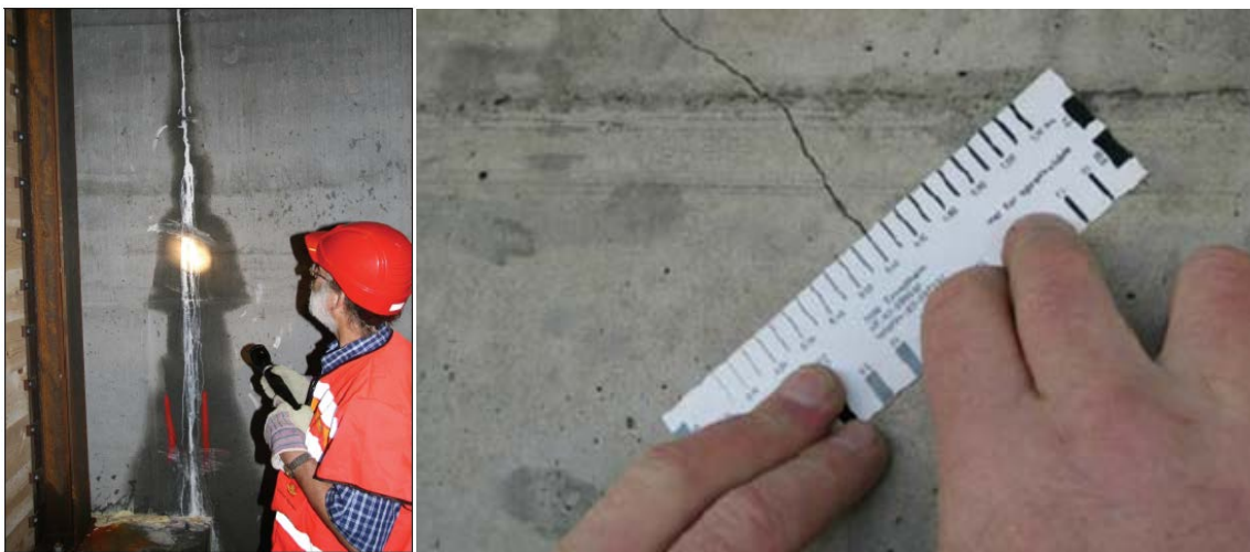
Figur 33 Reidar Kompen studerer lekkasje i riss i Bjørvika tunnelen i Oslo 2010 [39], og måling av rissvidde med risslinjal [26]
