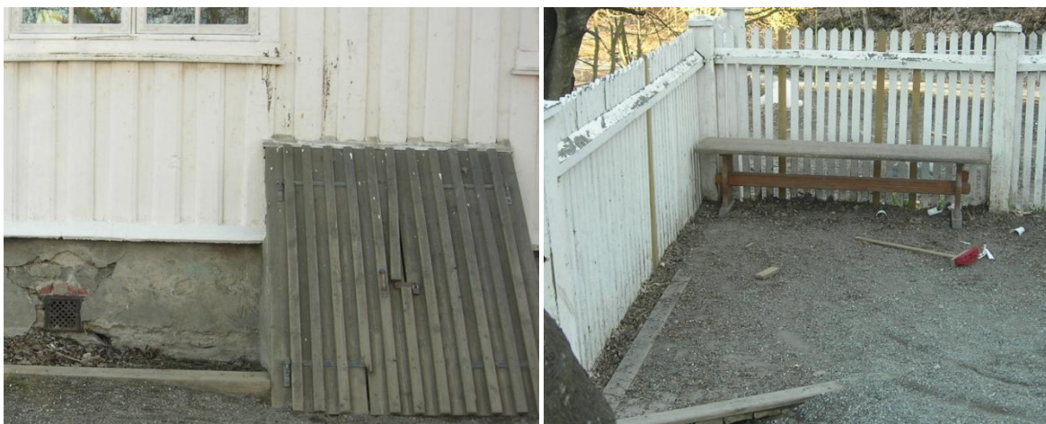
Figur 8.11.18 Husveggen og gjerdet er malt med blyholdig maling mens kjellerlemmen og plattingen er CCA-trykkimpregnert
