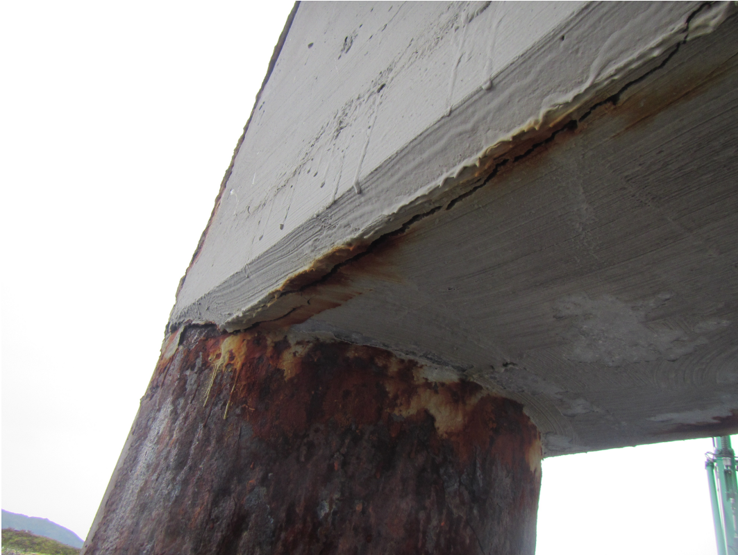
Figur 4.7: Sprekker med rustutslag på undersiden av tverrbærer i akse 9.
