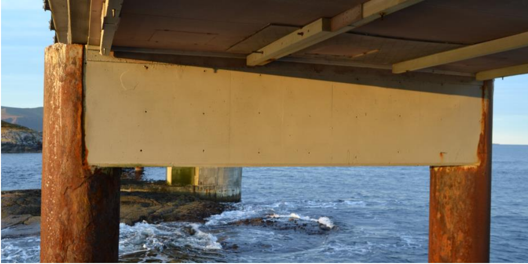
Figur 4.3: Ingen synlige skader på tverrbærere i akse 7, men kloridinnholdet overskrider grenseverdiene i EK 2.
