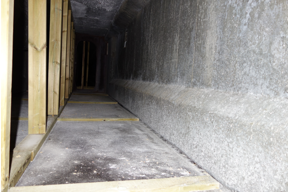
Figur 4.8: NIB-bejlkene har ingen synlige skader annet enn kalkutslag på overflaten.
