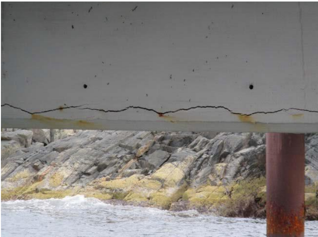
Figur 4.4: Riss og rustutslag på tverrbærere i akse 8.
