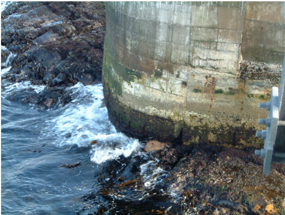
Figur 4.1: Utvasking mot fjell og rustutslag på landkar i akse 6.
