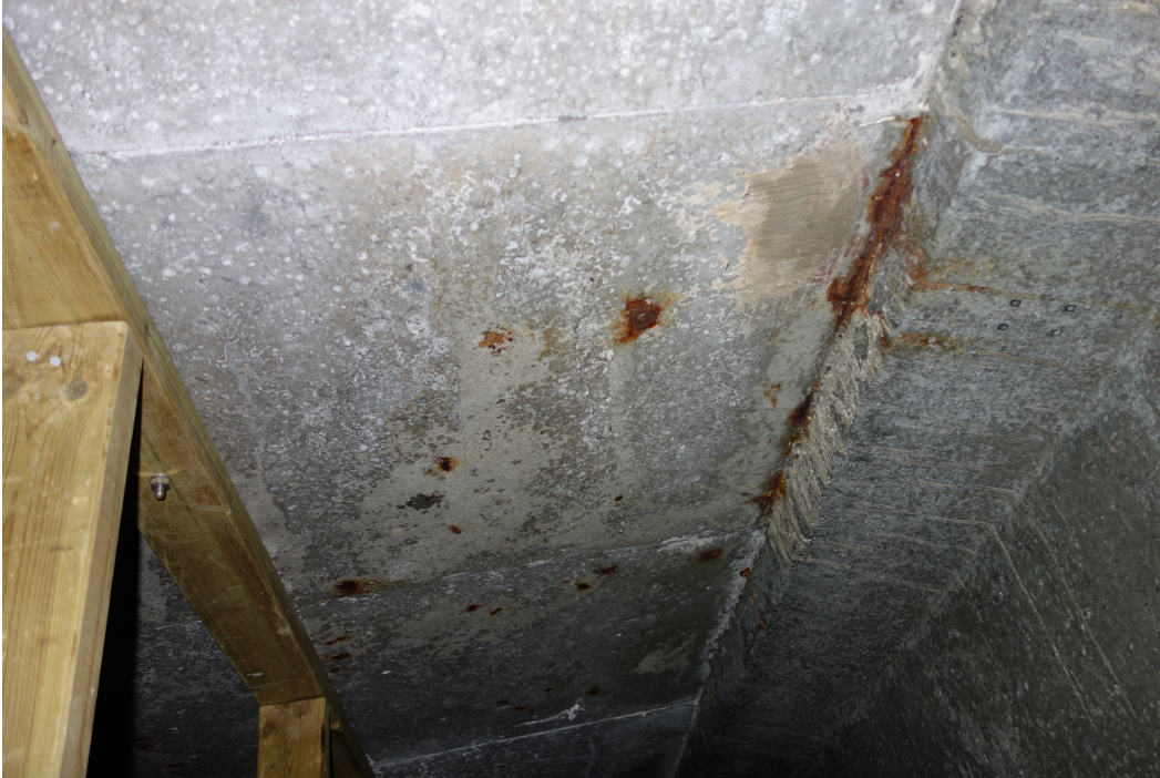
Figur 4.9: Rustutslag og bom under dekket. Bildet er tatt mellom akse 9 og 10 mellom innerbjelkene.
