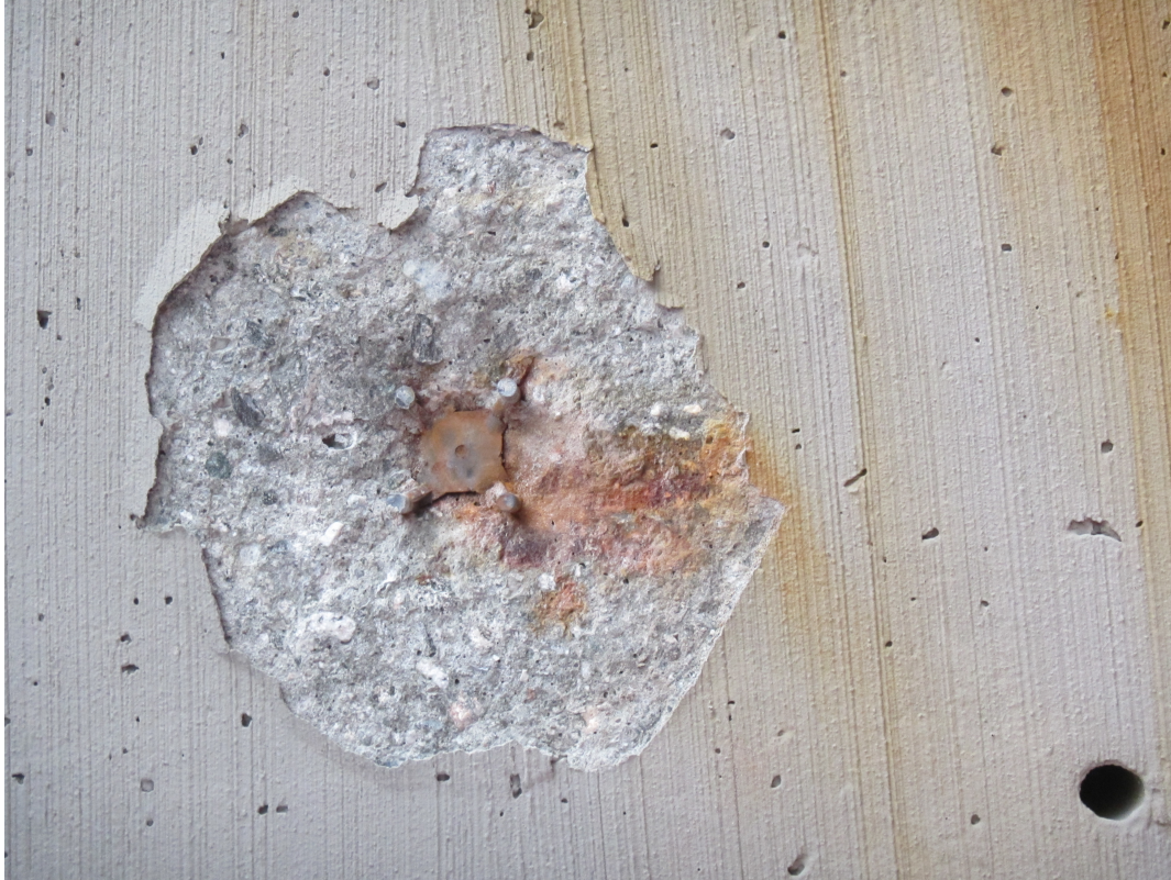
Figur 4.2: Synlig armering med korrosjon og bom på landkar i akse 10.
