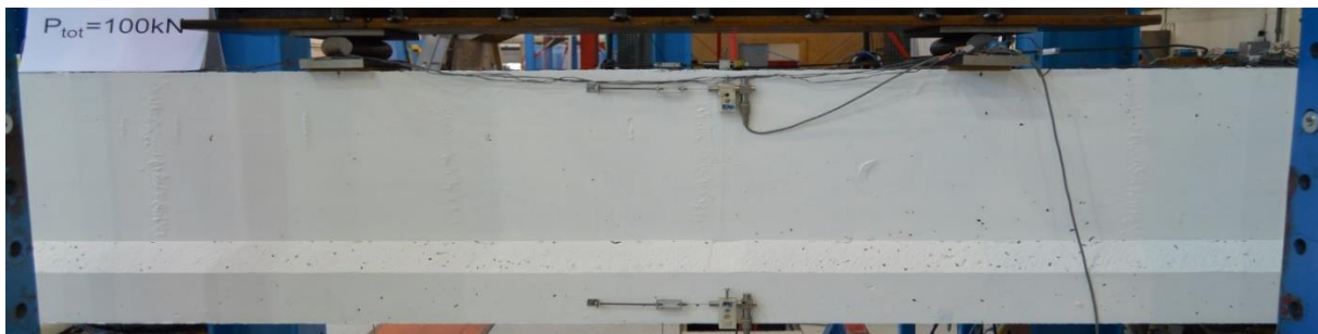
Figur A63: Rissmønster ved 100 kN, momentsone - bjelke 4
