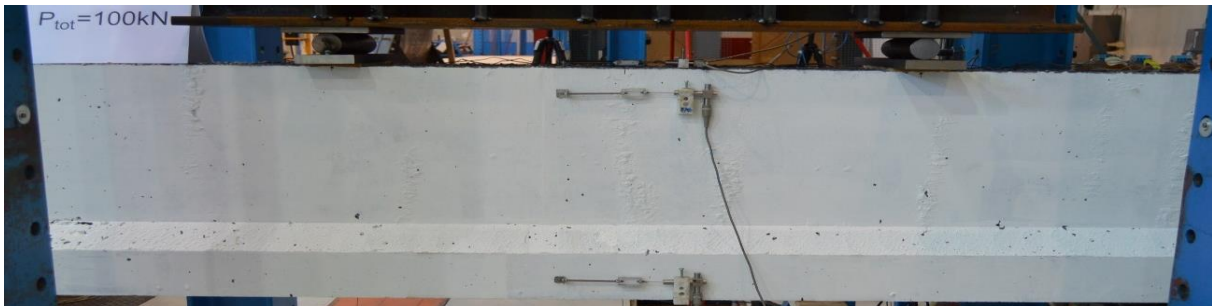
Figur A99: Rissmønster ved 100 kN, momentsone - bjelke 7
