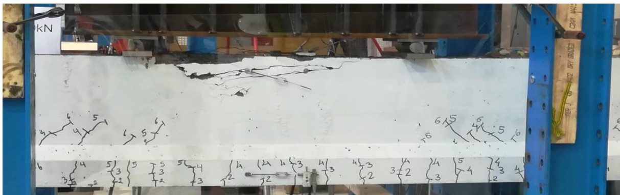
Figur 6.38: Første avskalling av bjelke 7 ved 1484 kN, «Topp 1»
