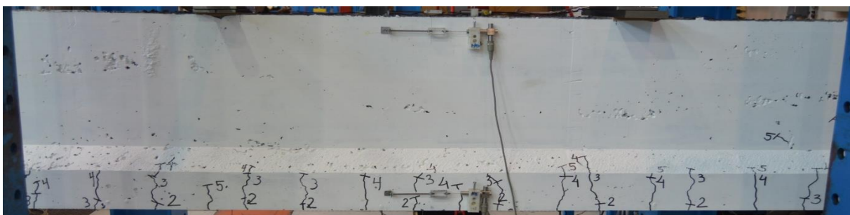
Figur A12: Rissmønster ved 700 kN, momentsone - bjelke 1
