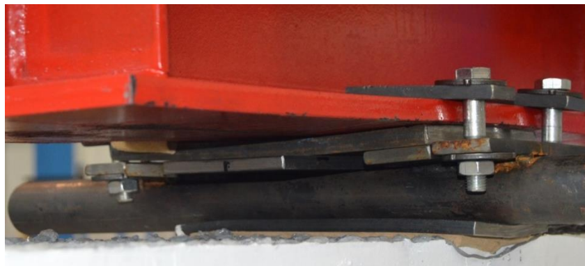
Figur 6.5: Store deformasjoner i opplager på venstre side
