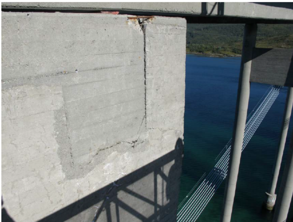
Figur 4.8: Kassepilar mellom akse 17 og 18 - sett fra sør nær akse 18[11]
