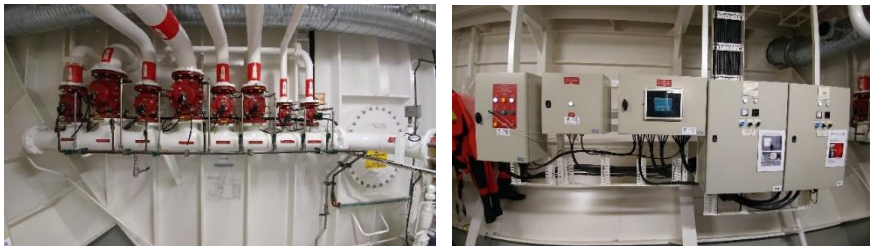
Figur 6: Brannpanel og rør for brannslukingsmidler
