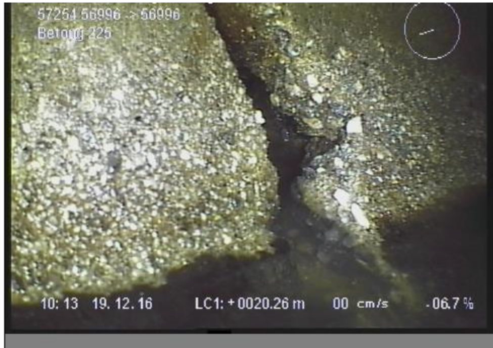
Foto: 1_1_6_19122016_100304_B.JPG, 00:08:21 19,9m, Sprukket rør, Rørbiter har løsnet eller mangler/teglstein mangler fra sin opprinnlige posisjon, fra 12 til 12 Kl., Kompleks
