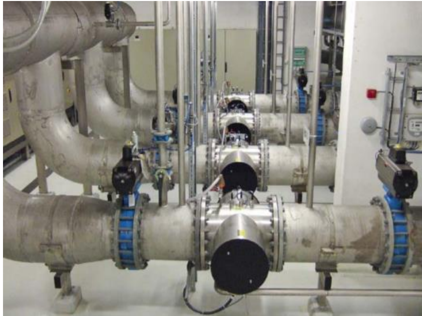
Figur 22. UV rensing inne i ett vannbehandlingsanlegg.
