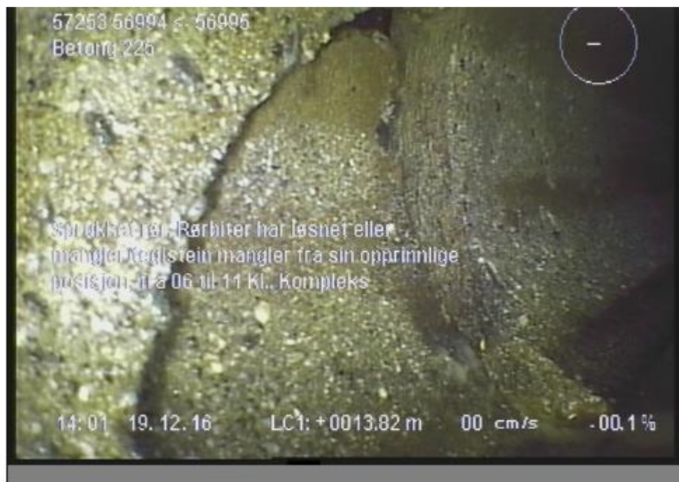
Foto: 3_1_4_19122016_135115_A.JPG, 00:03:46 13,8m, Sprukket rør, Rørbiter har løsnet eller mangler/teglstein mangler fra sin opprinnlige posisjon, fra 06 til 11 Kl., Kompleks
