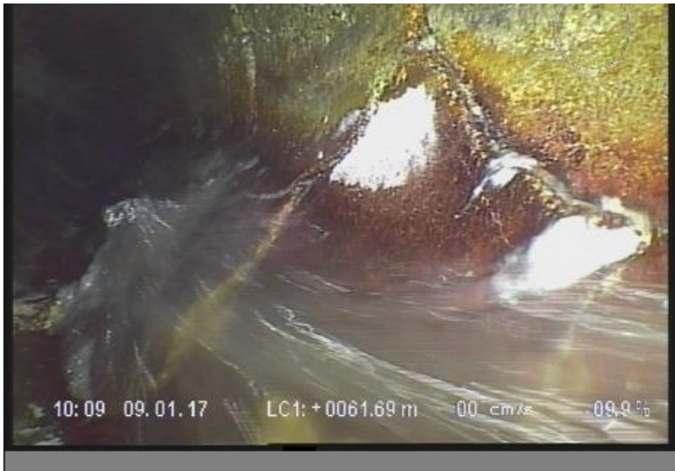
Foto: 1_1_54_09012017_095907_A.JPG, 00:52:18 61,6m, Sprukket rør, Rørbiter har løsnet eller mangler/teglstein mangler fra sin opprinnlige posisjon, fra 12 til 12 Kl., Kompleks
