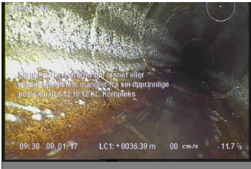
Foto: 1_1_31_09012017_092815_A.JPG, 00:21:28 36,3m, Sprukket rør, Rørbiter har løsnet eller mangler/teglstein mangler fra sin opprinnlige posisjon, fra 12 til 12 Kl., Kompleks
