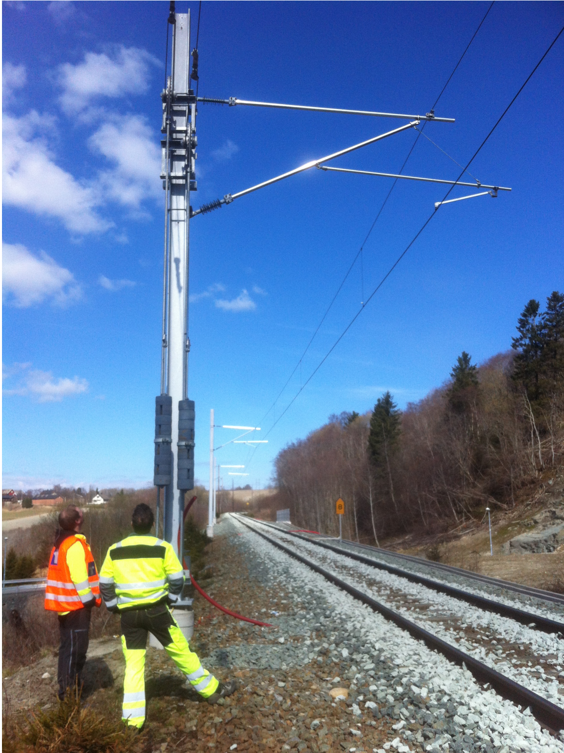
Figur 3.25: HE240B-avspenningsmast i Klettbyggene utenfor Trondheim. Dispensasjon ble skaffet fra Martin Rosvold, arbeidsplanlegger på Trønderbanen, til venstre på bildet.
