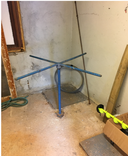
(a) Åpningsmekanismen til stengeventilen ved ventilhuset
