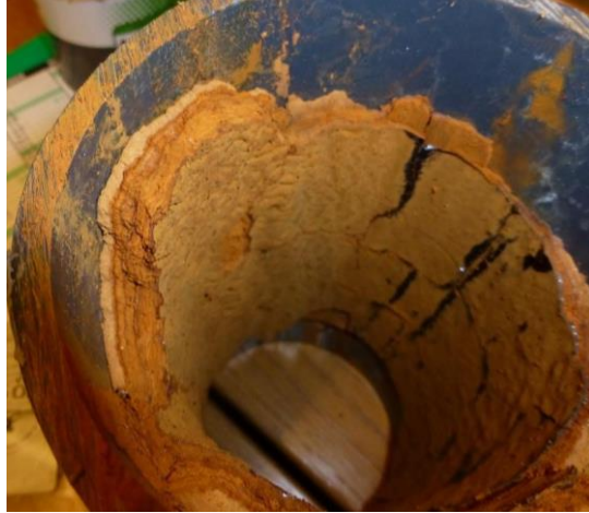
Figur 4.6: Beleggdannelse på innsiden av rør på Melhuset (Aune, 2016)
