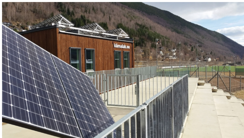
Figur 3.1: Oversiktsbilde av solcellepaneler
