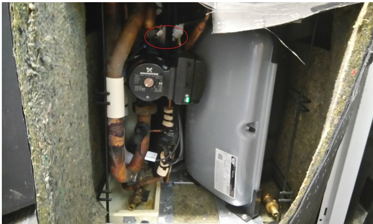
Figur 26 Nedre del av varmpumpa etter den er opna. Det er isolert rundt komponentane og ein kan sjå både sirkulasjonspumpa til brinekretsen og ekspansjonstanken.
