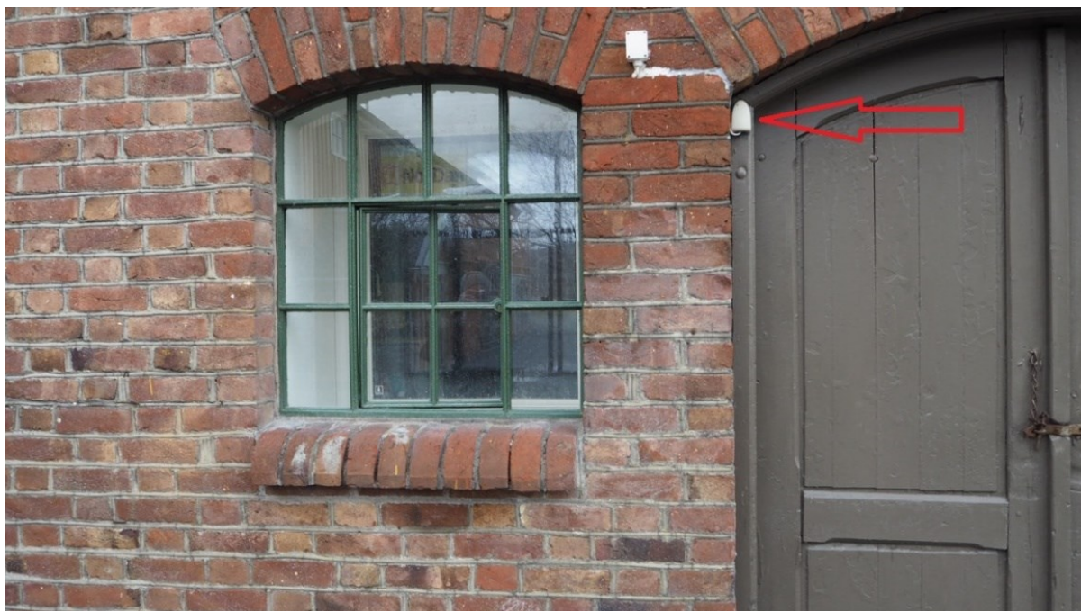
Figur 20 Plassering av temperaturfølar som styrer utetemperatur-kompenseringskurven i varmpumpa.
