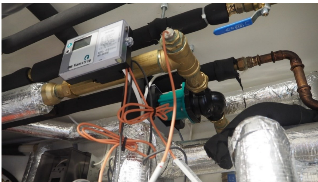
Figur 21 Bilete av innstikksventilen for temperaturfølararen i turrøyret til varmebatteriet.
