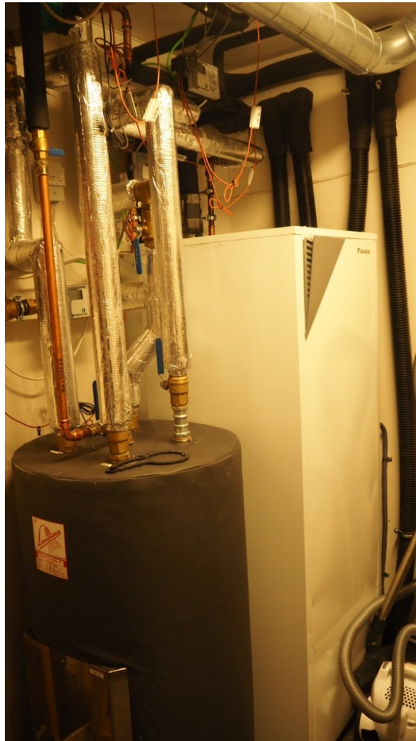
Figur 5 Bilete frå teknisk rom. Akkumuleringstank nedst til venstre, varmepumpa til høgre og to kursar til jordvarmeanlegget bak varmepumpa.
