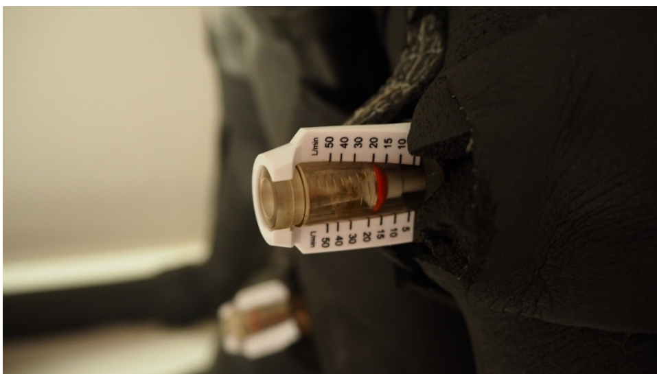
Figur 48 Bilete av innreguleringsventilane som vart byta ut. Det kan skimtast noko grums i midten av ventilen som følgje av ureinheitar i systemet.
