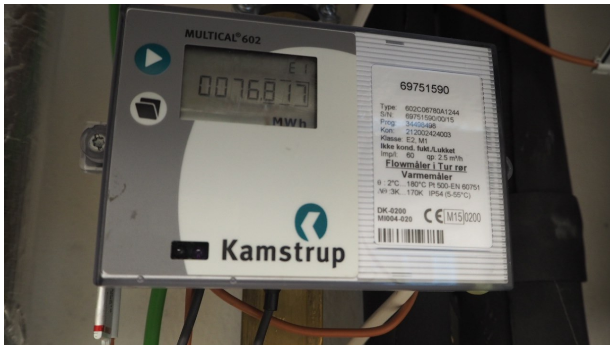
Figur 18 Bilete av ein av energimålarane på teknisk rom. Denne er for "Varmepumpe produksjon" og biletet vart teke 4.4.2017.
