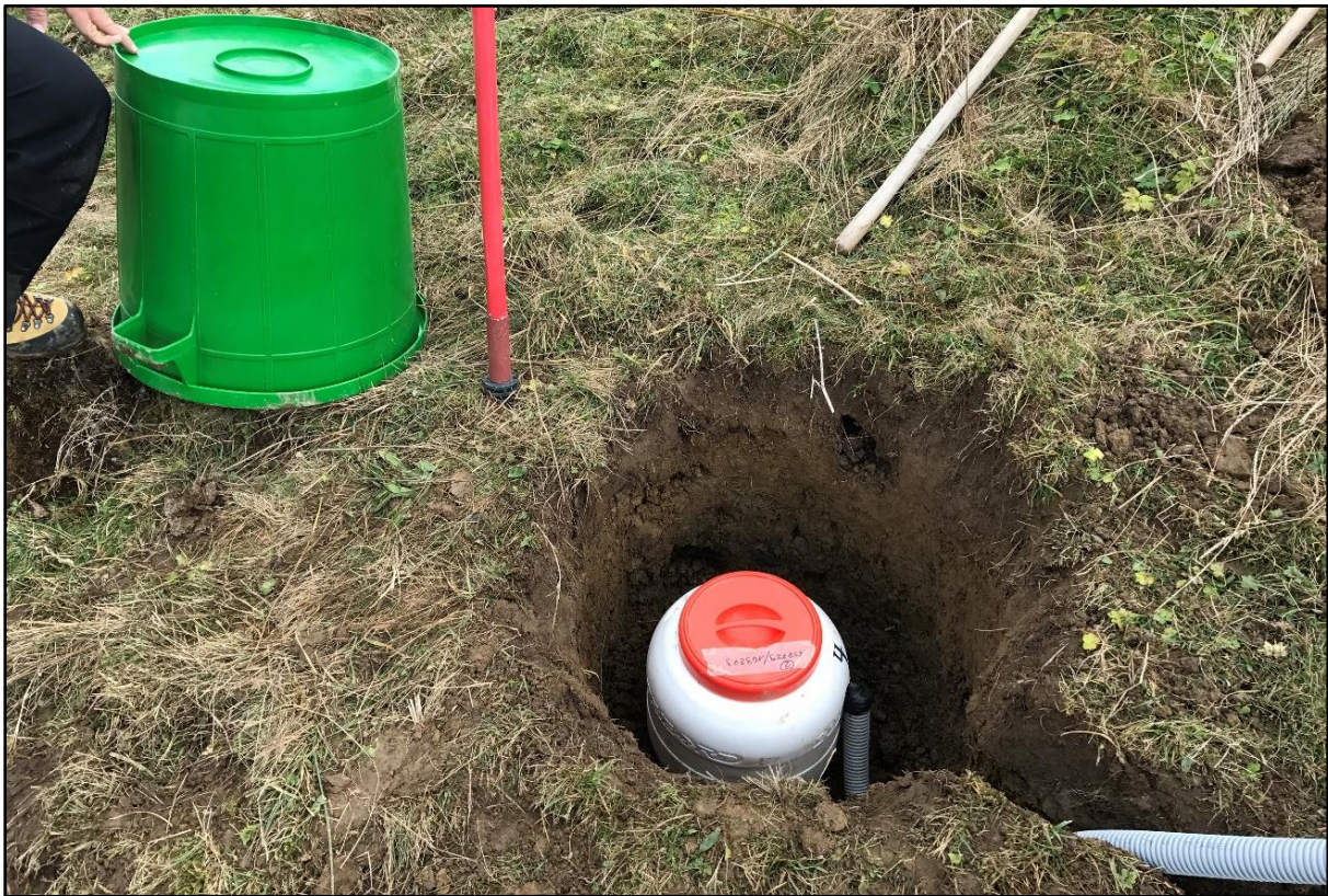
Figur 7-10: En av sensorene i et IDA-system i Sveits. Sensoren er gravd lengre ned enn ved tidligere installasjon av IDA-system med mål om å redusere støynivået ytterligere. Foto: Giacomo Ulivieri.
