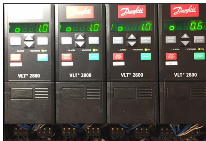
Figur 11.3 Frekvensomformerne innehar en funksjon for måling av belastningsstrøm.
