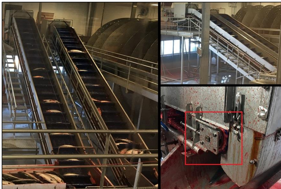
Figur 11.9 Trommelmotorene tilhørende stigebåndene i systemet for «Slaktning/Bløtting».
