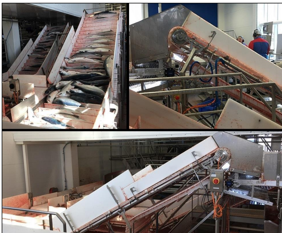
Figur 11.10 Trommelmotorene tilhørende stigebåndene i systemet for «Sløying».
