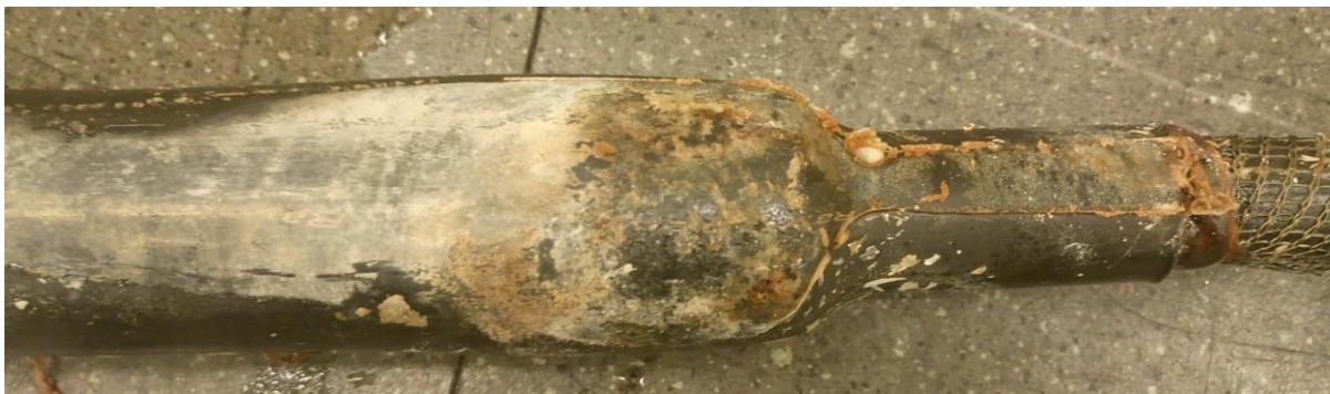
Figur 46: Bildet viser skjøten som har tørket ut. Dette har skjedd pga. fordamping av vann over natten.
