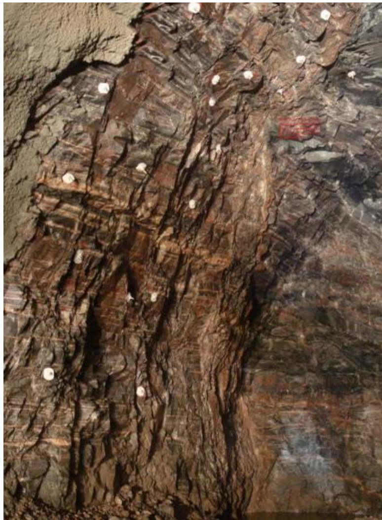
Figur 20: Markert, subvertikal sleppe, går ut i venstre vegg. Like rundt sleppen er berget kartlagt som noe oppknust, sideberget angis som middels godt fjell. Q-verdi sone: 0,6-0,75. Q-verdi sideberg: 3,3-6,2 (Todnem, 2010).
