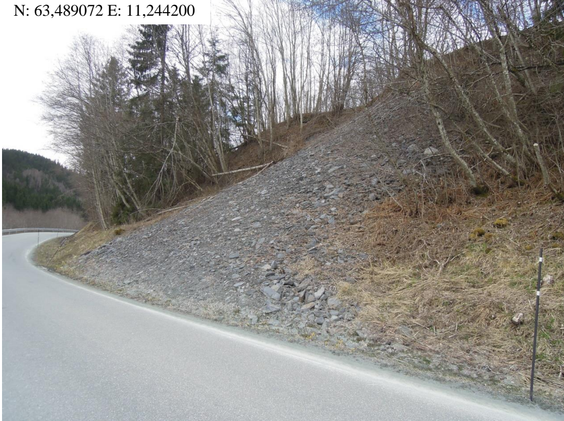
Figur 4.3.5: Erosjonssikring. Gjenfylt skredgrop omtrent 350 m vest for skredområdet. Bildet er tatt mot vest. Foto: Benjamin Trøan (3. mai 2017).
