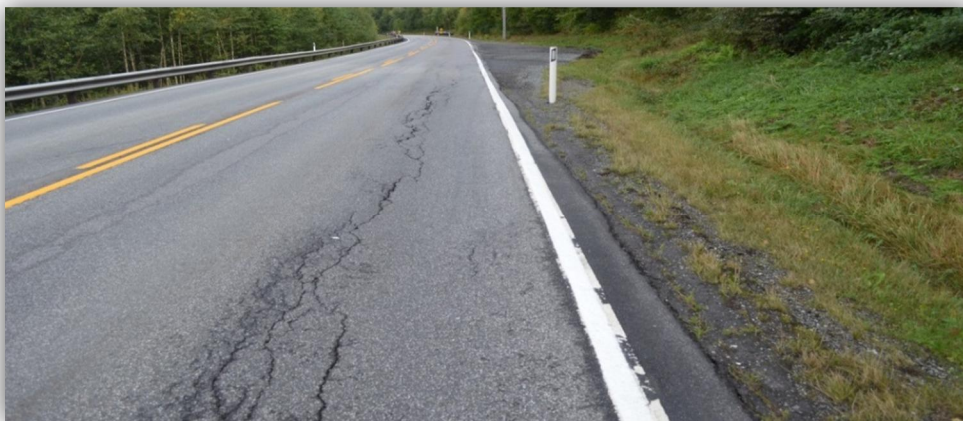
Figur 4 Eksisterende overbygning er underdimensjonert og skaper langsgående sprekker i vegdekket her ved profil 9910
