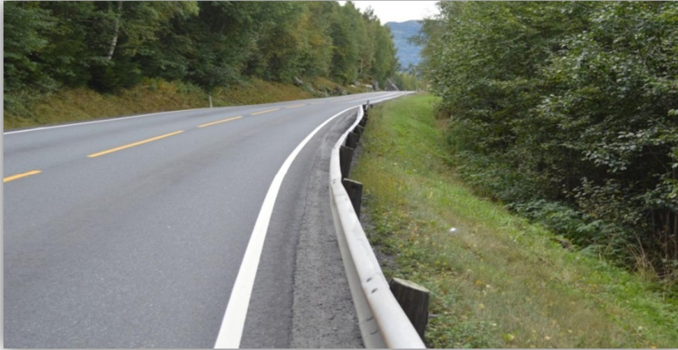
Figur 6 Sviktende rekkverk på grunn av mangel på rekkverksrom er et problem langs hele strekningen, her i profil 9350
