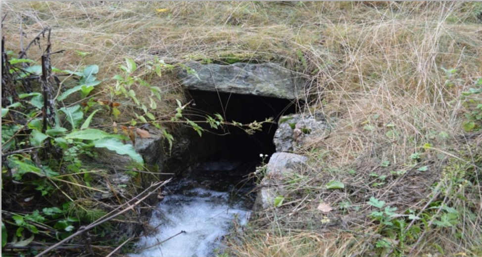
Figur 5 Et eksempel på stikkrenne som er moden for utskifting langs dagens eksisterende veg her i profil 10240
