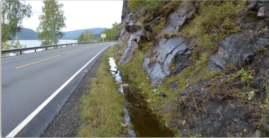
Figur 3 Problemer med drenering av overvann langs fjellskjæringene ved Miganberget
