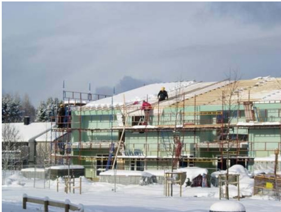
Figur 4.4.1 Bygging av boliger i Sjetnemarka, Sør-Trøndelag vinterstid. I utførelsesfasen er bygget svært utsatt for klimapåkjenninger, og det er viktig at bygningskroppen lukkes raskest mulig. Foto: Tore Kvande
