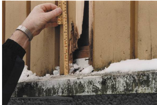
Figur 4.2.4 Kraftig råte observert ca 15 – 20 cm opp på stående kledning. Bildet viser også at vannbordbeslaget ikke er avsluttet inn under veggens vindsperrsjikt. Eventuell fuktighet på vindsperrren vil dermed kunne finne veien ned i underliggende konstruksjoner.
