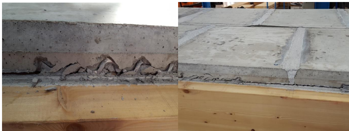
Figur 5.13 Brudd i skjærforbindelsen.
