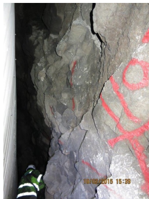
Figur 4.9: Situasjon bak tunnelhvelv. Generelt mye bart og lite sikret berg. Bergmassekvaliteten er oppsprukket og vurderes til dårlig (Vie og Ødegaard 2015)
