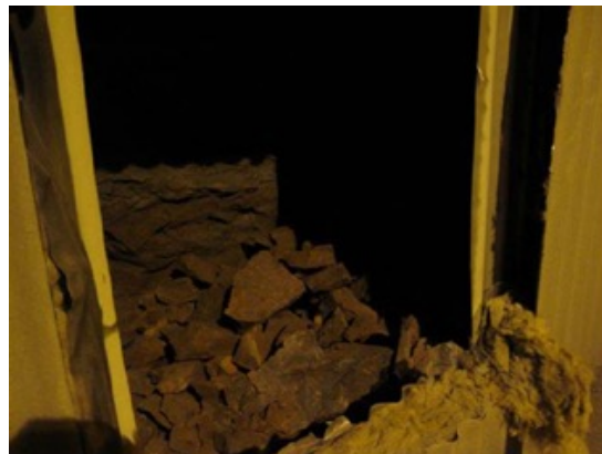
Figur 4.6: Her har det rast ut ca 1\text{ m}^3 med masser omtrent ved profil 2625 (Magnussen 2009)
