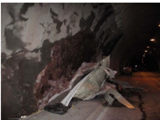
Figur 4.7: Ras i Holmestrandtunnelen 2009, omtrent ved profil 2685-2690 (Magnussen 2009)
