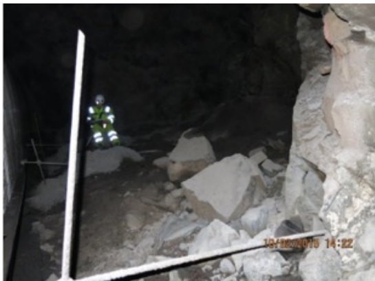
Figur 4.5: Rasmasser i vegg, ca ved profil 2625 (Magnussen 2009)
