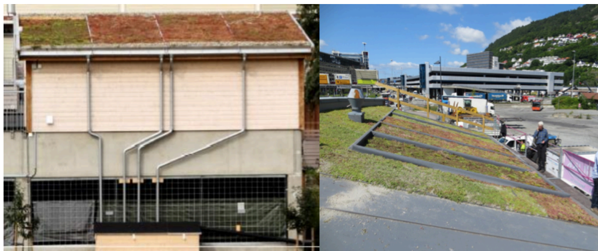
Figur 1: Det grønne taket i Trondheim (venstre) og i Bergen (høyre)
