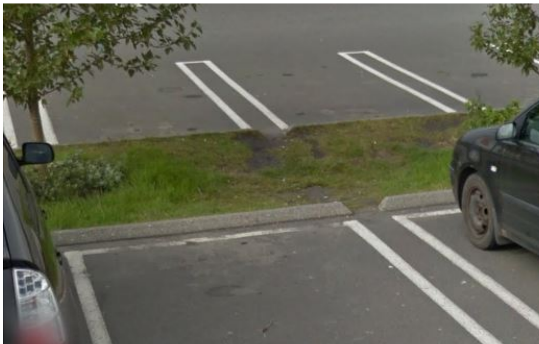
Figur 5.9: Erosjon ved innløp mellom parkeringsbarrierer ved IKEA, Kauptún. Foto: Google Maps (Street view).
