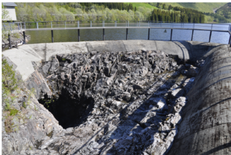
Figur 1.3 Terskel med gangbru og innløp til sjakt slik det er i dag (Foto: Magnhild Roe)
