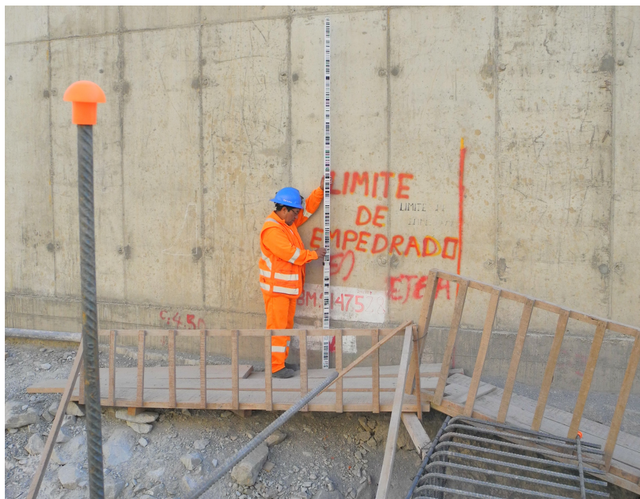
Figur 39: Måling ut i fra punkt på avledningskanalen, 8. august 2012 - punktet finnes ikke på tegninger.
